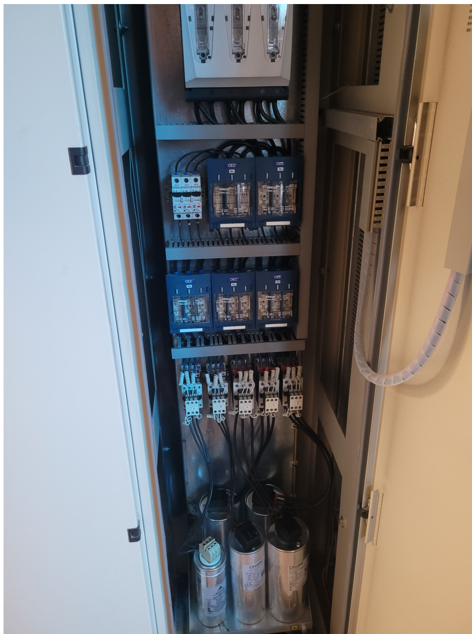
Rysunek 5 Widok szafy z baterią kondensatorów
